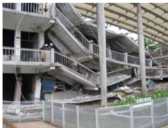
崩壊した小学校
